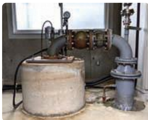
水源のポンプ
