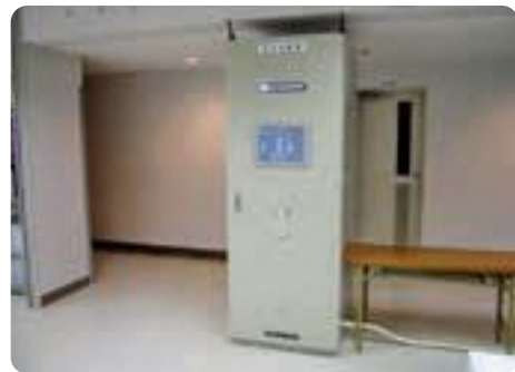
浄水場のコントロールパネル (現在、パソコン画面に状況を表示)
